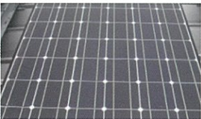
太陽光パネル
